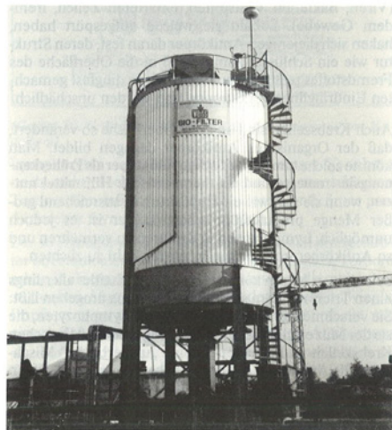
Biofilter zum Abscheiden gasförmiger organischer Verunreinigungen aus Abgasen. (Foto: Gebr. Weiss, Dillenburg)
